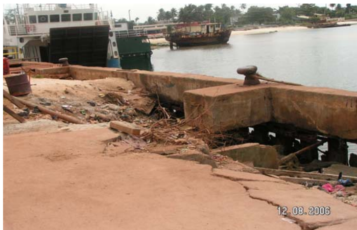
Photo 33 - Altération et éboulement des palplanches au port môle de Port-Gentil
