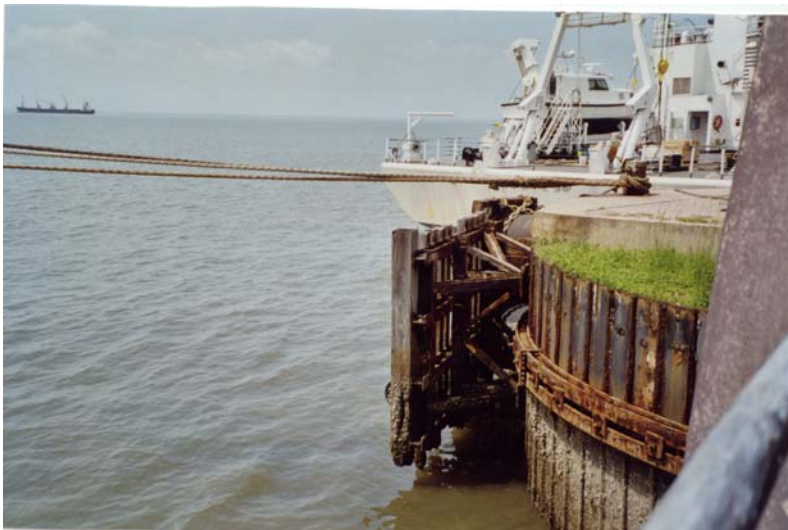
Photo 29- corrosion des gabions du poste pétrolier (ports d'Owendo)
